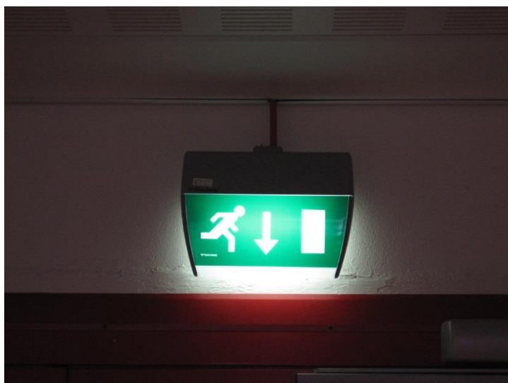
Bild 3 (Vägledningsbelysning som visar utrymningsriktningen)
